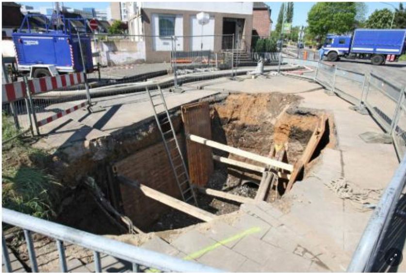
Dieses Loch klafft in einer Straße in Düren. Foto: Ralf Roeger
